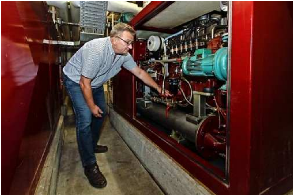
Peter Strauss vor einem der 18 Jahre alten Motoren im Blockheizkraftwerk. Foto: FACTUM-WEISE
